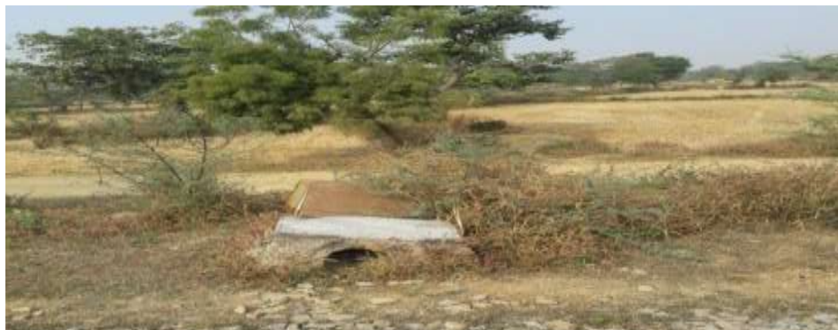
पुल संख्या 17 खंड और कटिंग सेक्शन के नल बिंदु के बीच रेलवे लाइन पर स्थित स्वचालित सिग्नलिंग प्रणाली का स्टील उपकरण केस ध्वस्त हो गया है।
